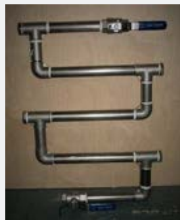
Roestvrijstaal corrosierek, met isoleerkranen
