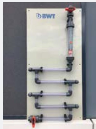
Pvc-corrosierek op paneel, met isoleerkranen, rotameter en transparante secties
