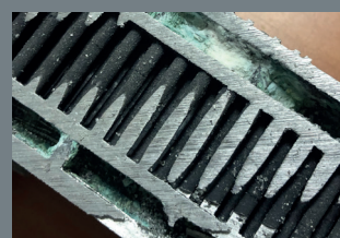
Coupe du corps de chauffe corrodé
