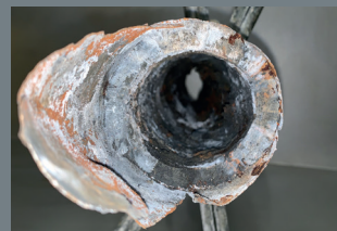
Embouage et amorce de corrosion sur le circuit
