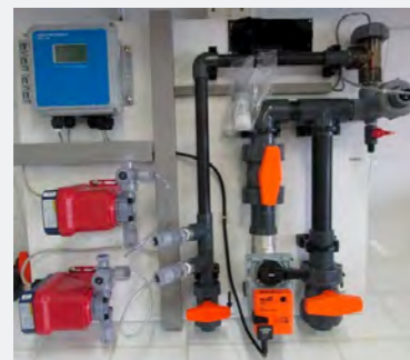
Tours de refroidissement Gestion de l'ensemble du traitement
