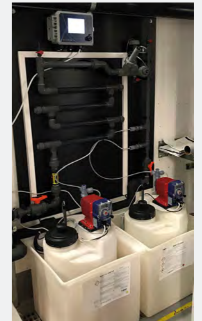
Circuits de refroidissement Gestion de l'ensemble du traitement
