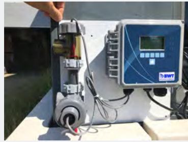
Tour de refroidissement Contrôleur de base - Gestion de la purge
