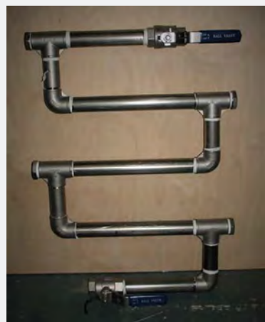
Rack de corrosion inox, avec vannes d'isolement
