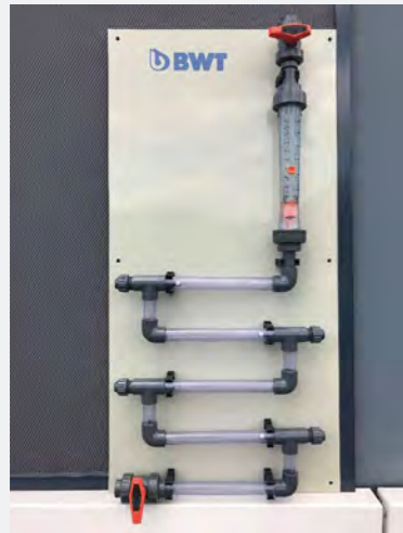
Rack de corrosion PVC sur panneau, avec vannes d'isolement, rotamètre et sections transparentes
