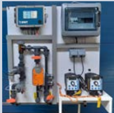
Tour de refroidissement : dosage, mesure, régulation et contrôle à distance par Modem
