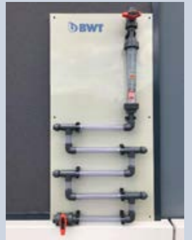
Rack de corrosion PVC sur panneau, avec vannes d'arrêt, rotamètre et sections transparentes
