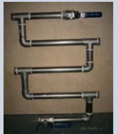
Rack de corrosion inox, avec vannes d'isolement
