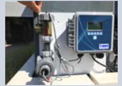
Tour de refroidissement Contrôleur de base - pour la purge automatique
