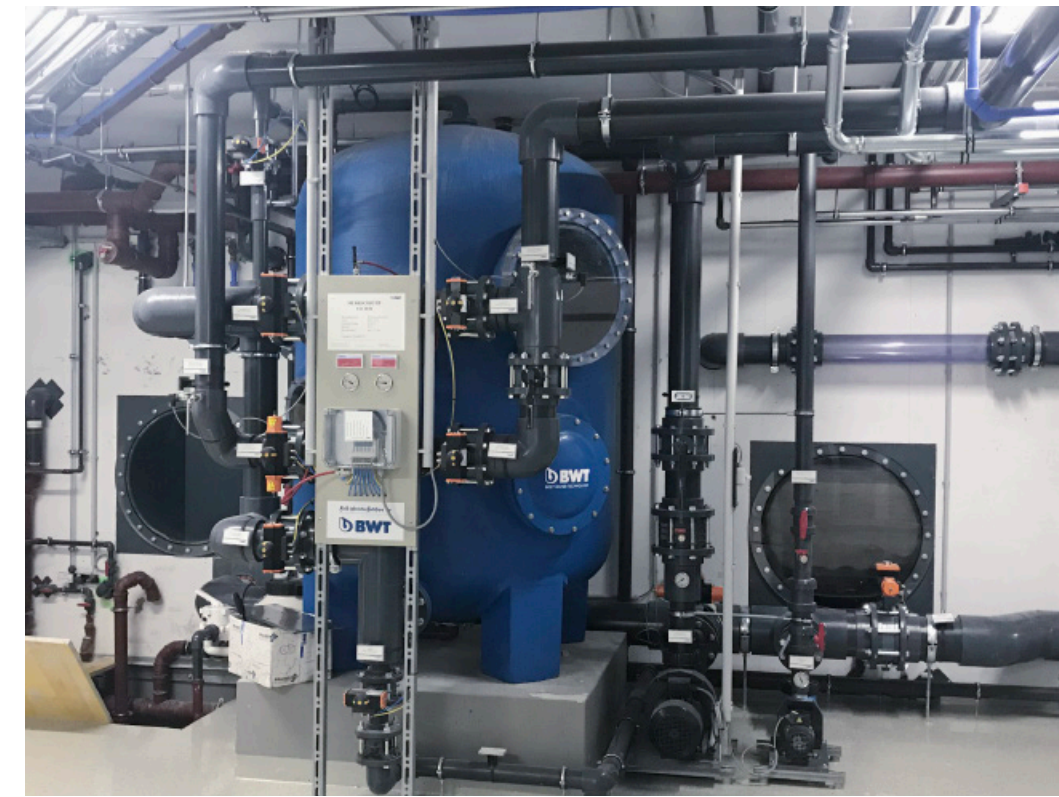
BWT Energy Solutions & Ressource Management bietet einen ganzheitlichen Ansatz zur Modernisierung und Optimierung von Poolanlagen, um erhebliche Energieeinsparungen zu realisieren.
